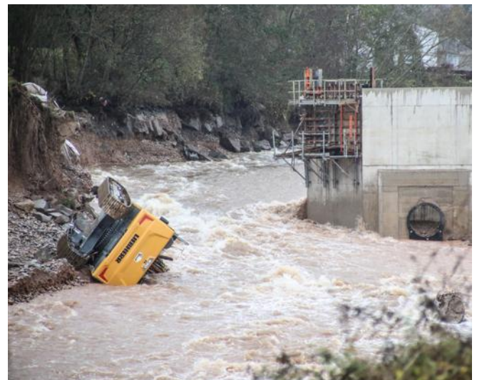
Près de Saint-Dié-des-Vosges, à Saulcy-sur-Meurthe, une digue a été emportée. Photo Florent Seiler
