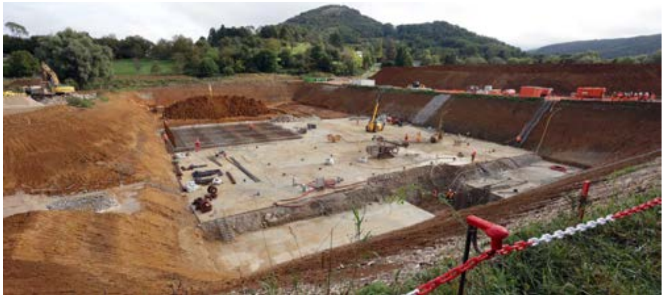
Le bassin d'orage de Besançon, dont le chantier a commencé en mai 2021, s'étend sur environ 500 mètres. Il sera en mesure d'absorber 20 000 m 3 d'eaux usées lorsque les intempéries seront conséquentes. Photo Ludovic Laude
